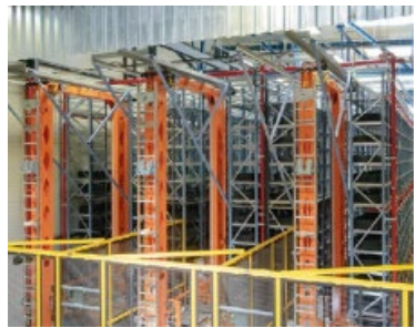
Almacén de neumáticos de gran altura
